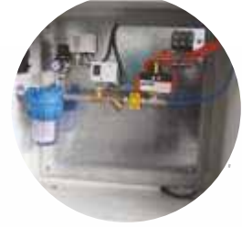
Pnömatik Kontrol Merkezi Pneumatic Control Center
